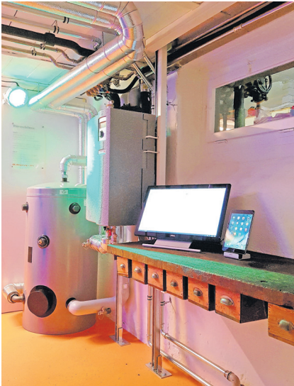
Wärmepumpe mit natürlichem Kältemittel, rechts daneben Werkbank aus dem Jahr 1947 Bilder: zVg
