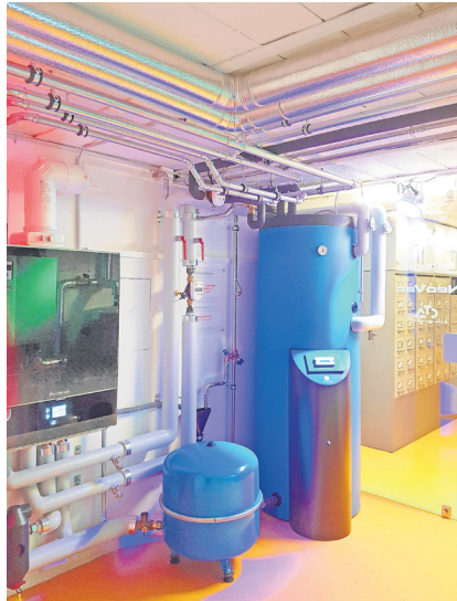
Links die Gastherme, rechts der Solarboiler
